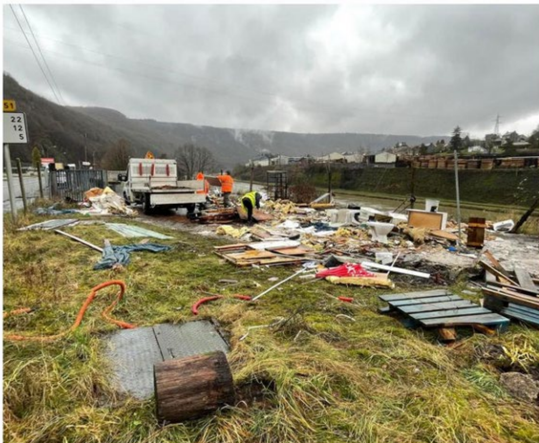
Des agents municipaux s'activent sur le site de l'ancienne friterie Chez Pat, pour le nettoyer. N.P.
